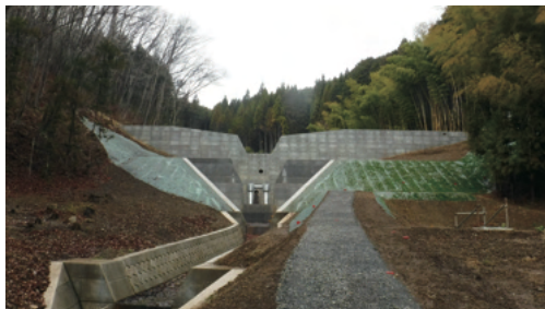
不透過型砂防えん堤
