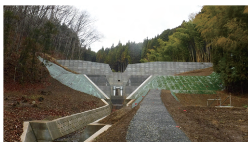
不透過型砂防えん堤
