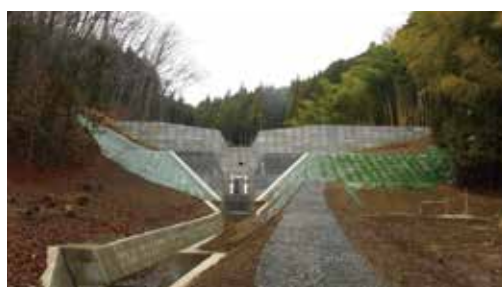
不透過型砂防えん堤
