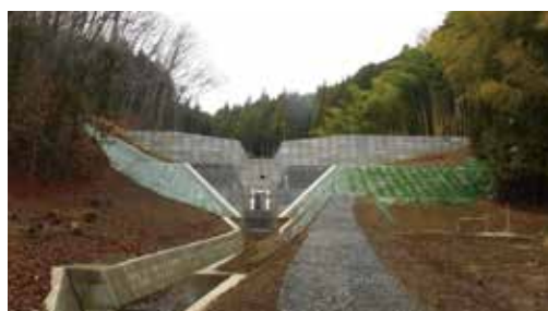
不透過型砂防えん堤
