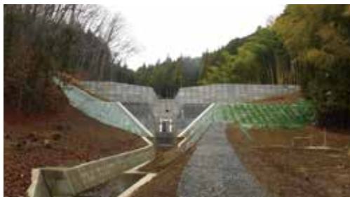
不透過型砂防えん堤
